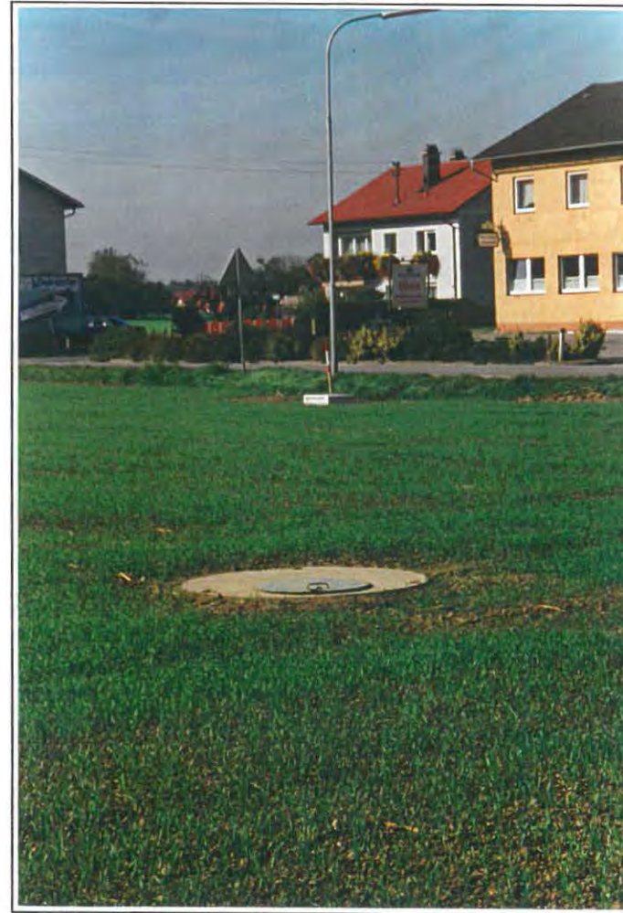
Foto 6: Meßschacht Lysimeter "Pucking", im Hintergrund Sickerwassersammler B
